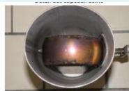
Position du catalyseur : « by pass »
