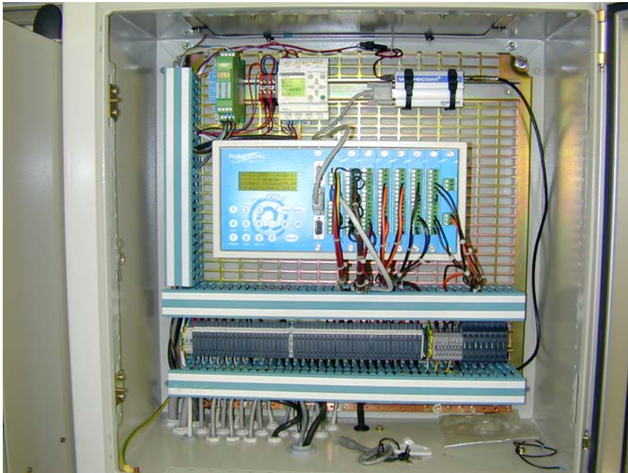
Photo 6 : Station d'acquisition Op@l avec modem GSM installée dans la station de mesures de Créhange
