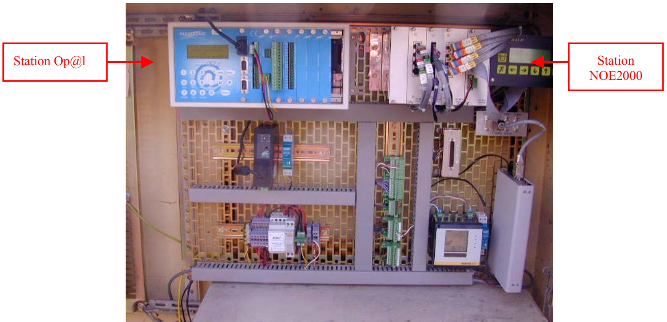
Photo 1 : station de démonstration PLQ2000 composée d'une station Op@l et d'une station NOE2000
