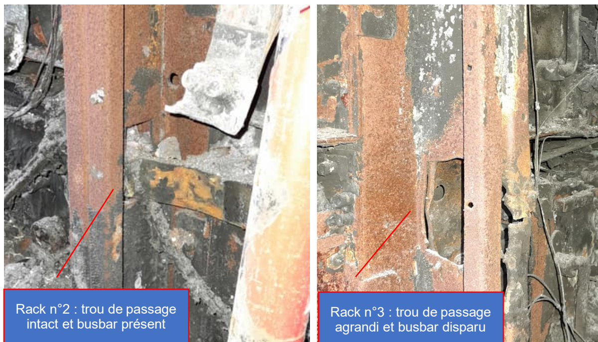
Figure 19: Passage du busbar entre les modules n°7 et 8, au sein du rack n°2 (gauche) et du rack n°3 (droite)
