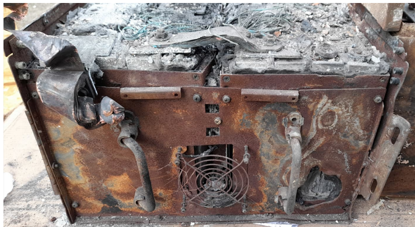
Figure 30: Prélèvement du module n°1 du rack batteries n°2 : vue de face
