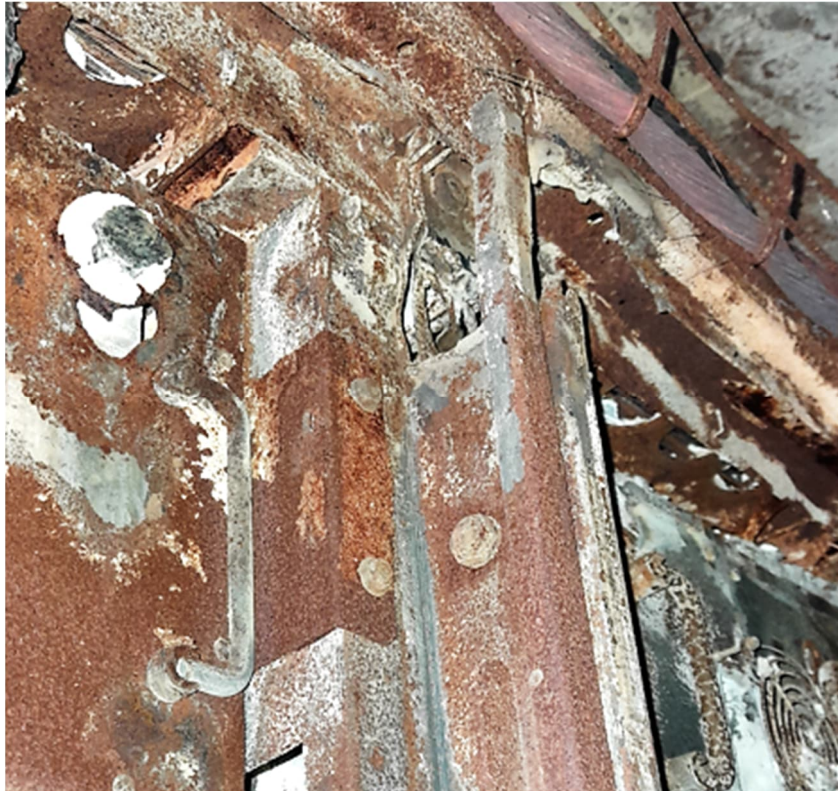
Figure 10 : Passage du busbar entre le module n°15 et le boîtier BPU, au sein du rack n°3
