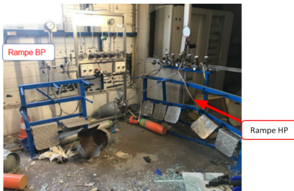
Figure 2 : rampes de test BP et HP après l'explosion
