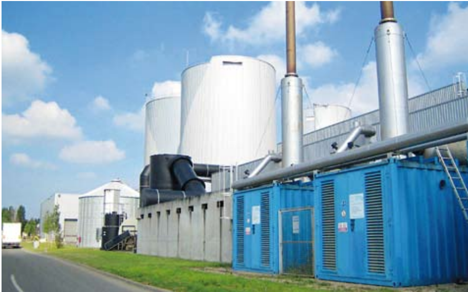
Valorisation du biogaz en énergie électrique sur une installation industrielle.
